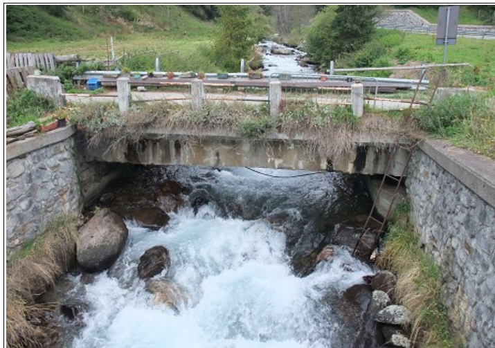
Fotografia 36 – Punto critico per possibile esondazione delle acque del Torrente Frigidolfo sotto Precasaglio a causa della sezione ridotta del ponte del vecchio tracciato della S.S. n. 300 per il Gavia.
