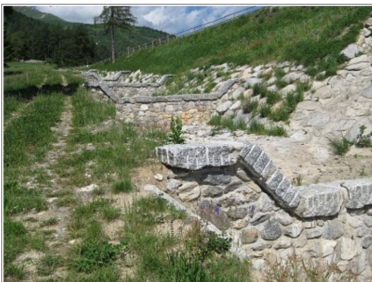
Fotografia 56a -56b -56c – Valle del Lares a monte della S.S. n. 42 del Tonale con muri spondali e selciato di fondo, a valle della S.S. n. 42 in corrispondenza di un guado di attraversamento di una stradina sterrata dove l'acqua potrebbe uscire e tratto finale che costeggia il laghetto di innevamento
