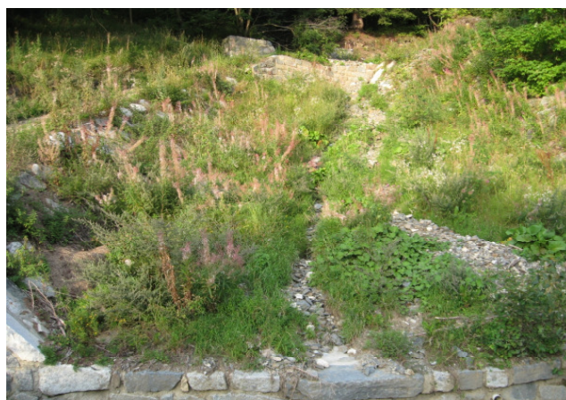
Apice della conoide dove si intravedono sullo sfondo e in primo piano le briglie e soglie realizzate per trattenere il materiale
